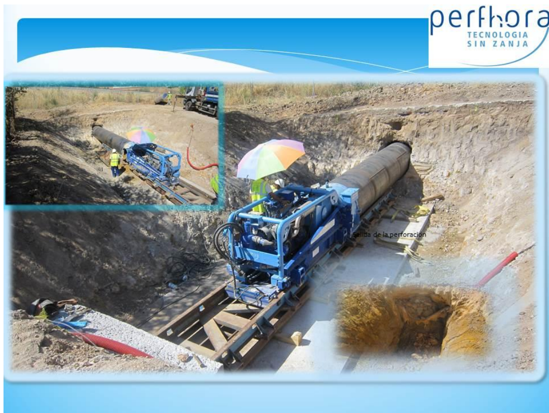
Figura 41 Reporte del proyecto de instalación de tubería de alcantarillado mediante el método Auger Boring en Zamora, España. Fuente: (PERFHORA, 2023)
