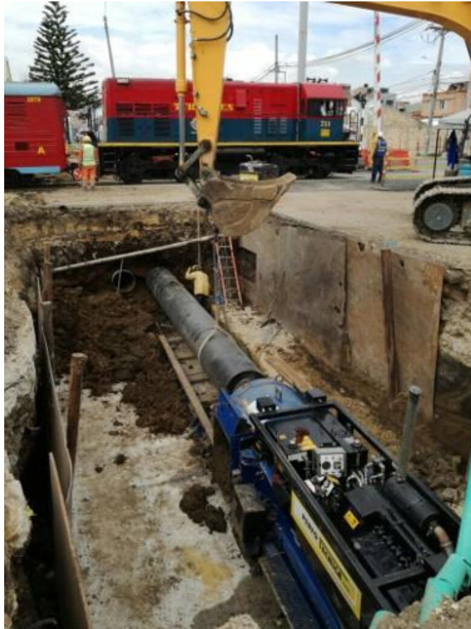
Figura 37 Reporte del proyecto de instalación de tubería de alcantarillado mediante el método Auger Boring en la Calle 183 de Bogotá. Fuente: (PERFOTÉCNICA, 2023)
