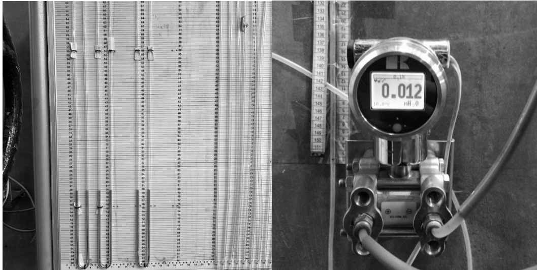
Figura 4. Aparatos de medición de pérdida de presión.
