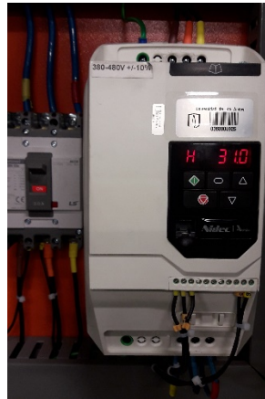
Figura 18. Variador de velocidad de la bomba
