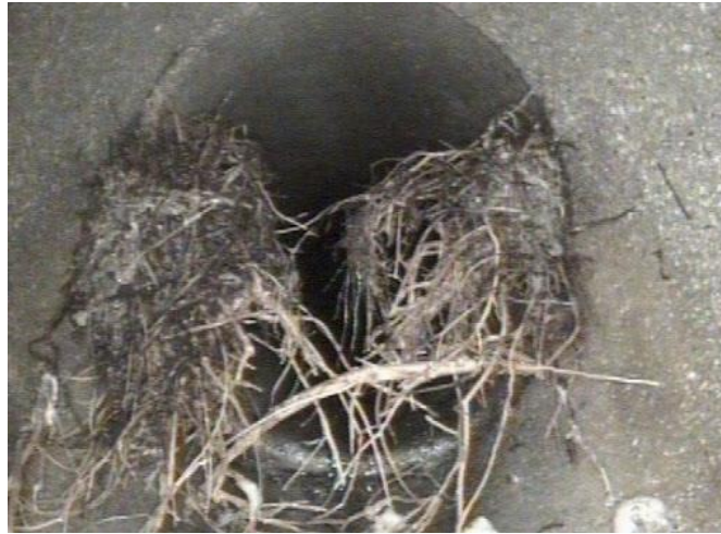
Figura 6: Ingreso de raíces a sistemas de alcantarillado. (Eurolimpiezas, s.f.)
