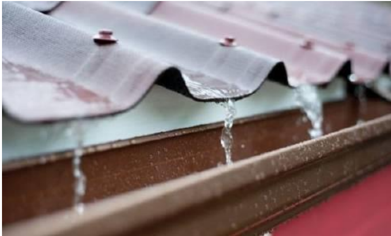
Figura 9: Canaletas implementadas en techos. (Benito, 2015)
