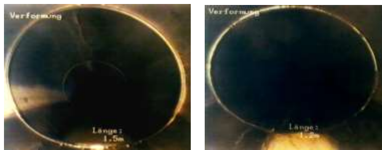
Figura 3-7. Deformación de una tubería de polietileno de alta densidad (HDPE). Tomado de Stein & Stein, 2004.
