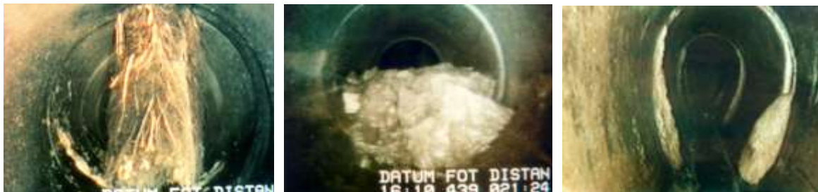
Figura 3-3. Obstrucciones de flujo en tuberías. (a) Intrusión de raíces, (b) depósitos de residuos, (c) incrustación. Tomado de Stein & Stein, 2004.
