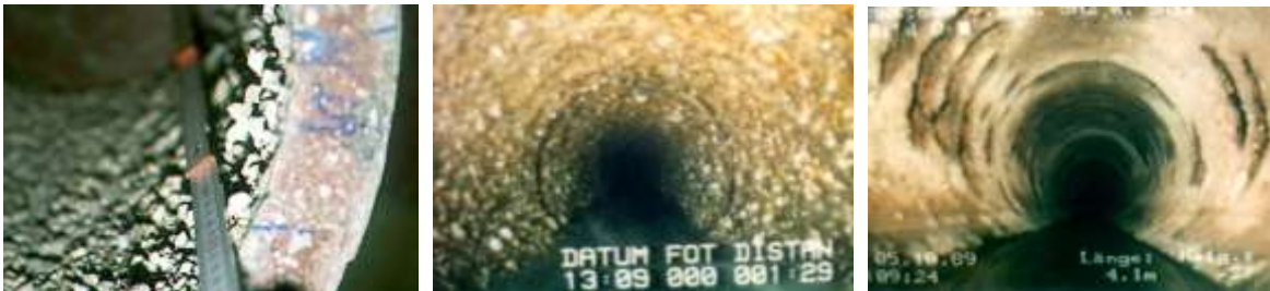
Figura 3-4. Corrosión de la superficie interior de una tubería. Tomado de Stein & Stein, 2004.
