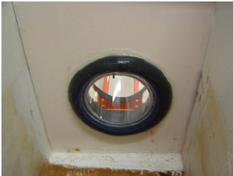
Ilustración 42. Vista de la compuerta con el neumático.
