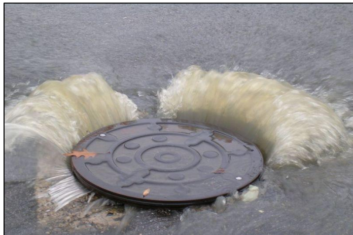
Figura 2.4. Ejemplo de sobrecargas en la red de alcantarillado 1 .
