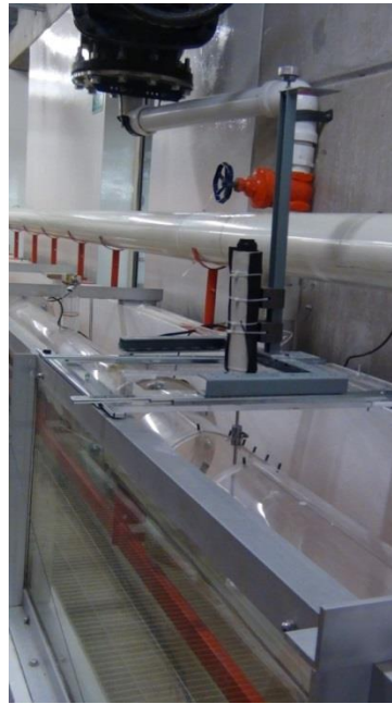
Ilustración 20. Adaptación del ADV en la tubería.
