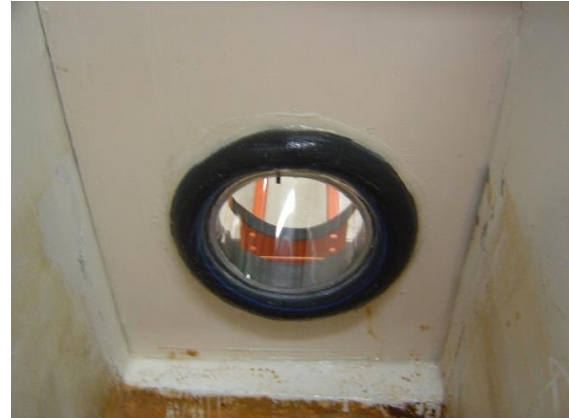
Ilustración 14. Vista de la compuerta con el neumático.
