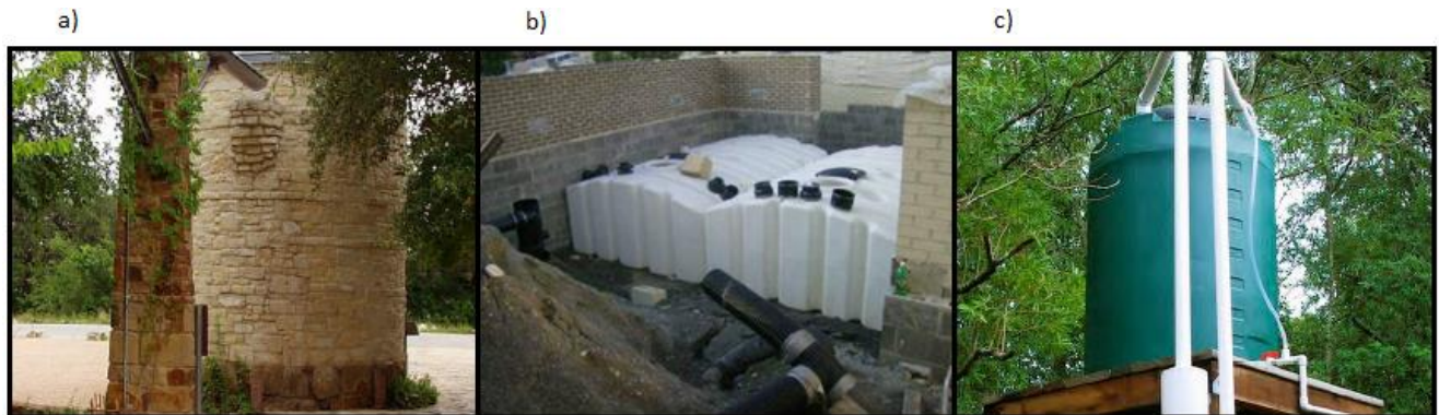
Figura 8-1. a) Sistema de almacenamiento activo del Lady Bird Johnson Wildflower Center – Austin, Texas (Fuente: [53]), b) sistema de almacenamiento activo del Claude Moore Educational Complex – Roanoke, Virginia (Fuente: [95]) y c)
