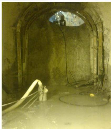
Figura 10. Agua de infiltración en los túneles de Amoyá.
