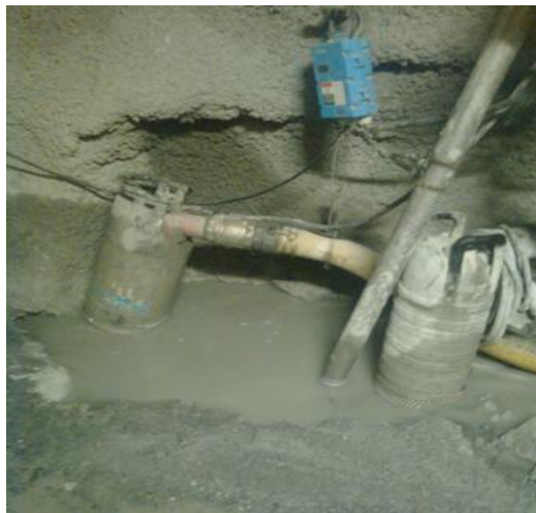
Figura 22. Bombas encendidas sin agua suficiente para bombear.
