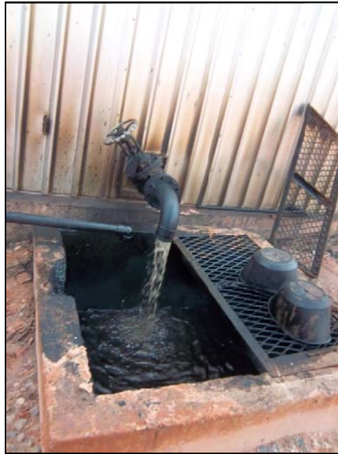
Figura 6. Drenaje de fondo de tanques de almacenamiento de crudo tratado. Fuente: La autora, 2011.
