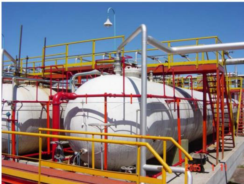
Ilustración 6-4. Tanque sellado para la implementación de DRAs. Adaptada de: (Facultad de Ingeniería UBA, 2007).
