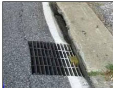
Figura 4-3 Sumideros de rejilla
