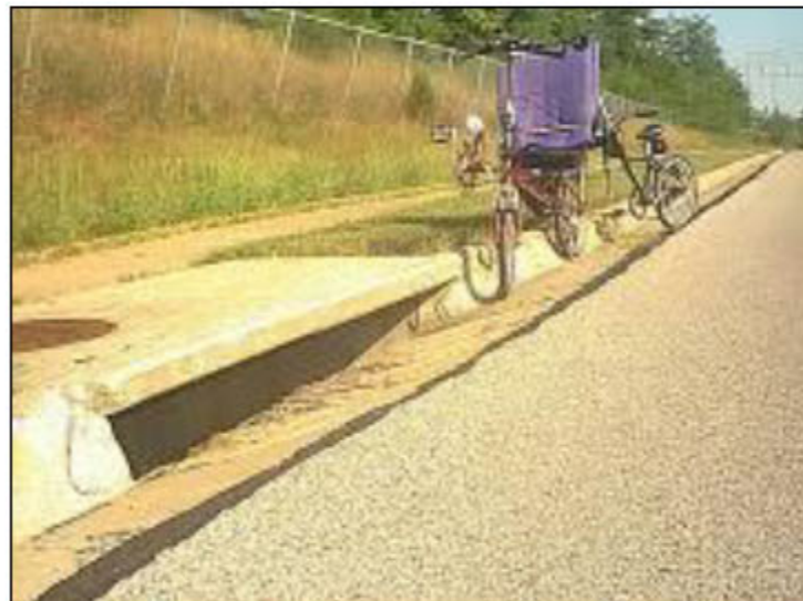
Figura 4-2 Sumideros de Ventana
