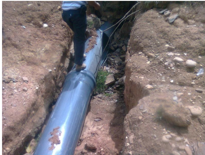
Fotografía 5. Explosión tubería río Medina – Honda. Fuente: Autor.
