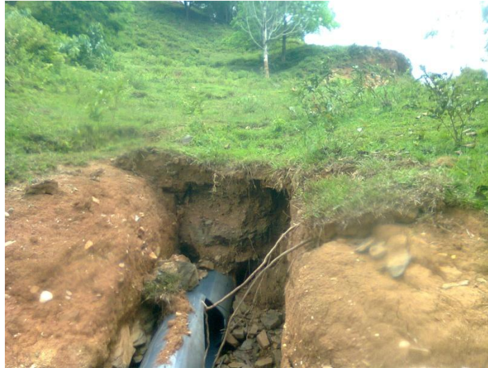
Fotografía 7. Explosión tubería río Medina (3) – Honda. Fuente: Autor.
