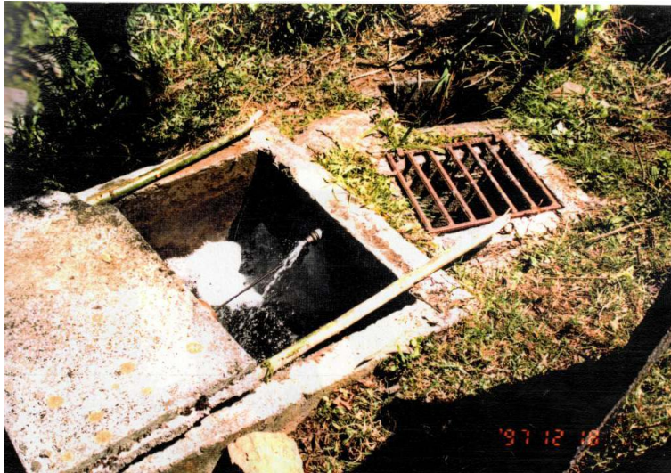
Fotografía 2. Válvula de flotador con fugas. Fuente: (Camargo Gómez, 1999).
