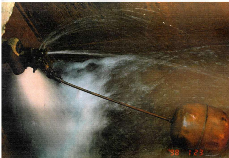
Fotografía 3. Válvula de flotador con fugas (2). Fuente: (Camargo Gómez, 1999).
