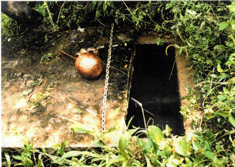
Fotografía 4. Válvula de flotador dañada. Fuente: (Camargo Gómez, 1999).
