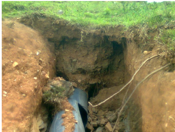
Fotografía 6. Explosión tubería río Medina (2) – Honda. Fuente: Autor.
