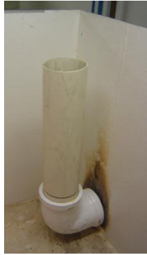
Figura 17. Rebose de tanque elevado.
