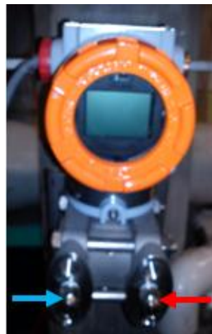
Figura 15. Sensor diferencial de presión y ubicación de piezómetros.
