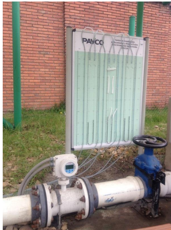
Figura 26. Medidores (diferencia de presión, caudalímetro y válvula de regulación de caudal) en PAVCO S.A (Nieto, 2011).
