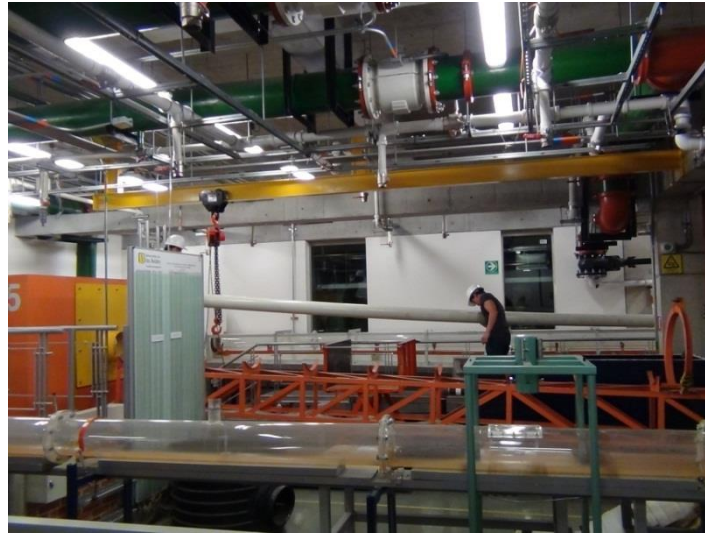
Figura 75. Ubicación de la tubería en el laboratorio (XV).
