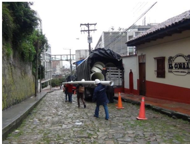
Figura 53. Desplazamiento de la tubería (II).
