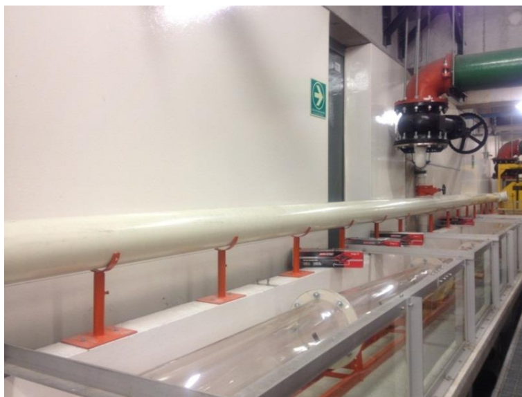
Figura 90. Tubería principal soportada.
