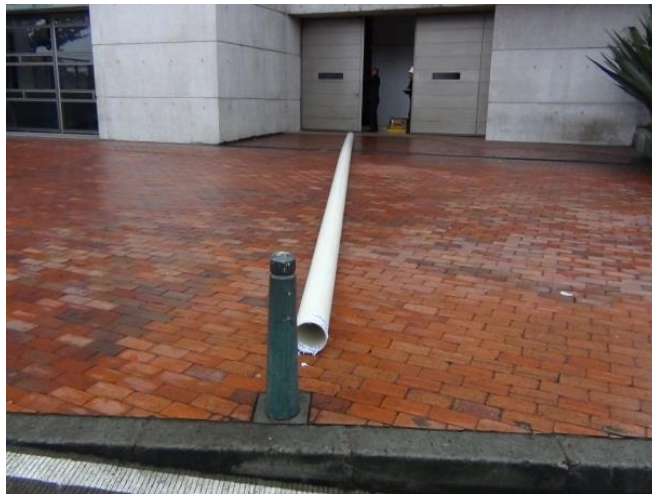
Figura 56. Desplazamiento de la tubería (V).
