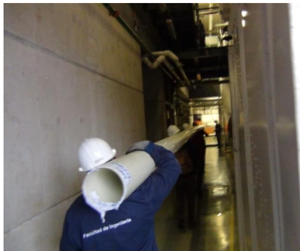
Figura 59. Desplazamiento de la tubería (VIII).
