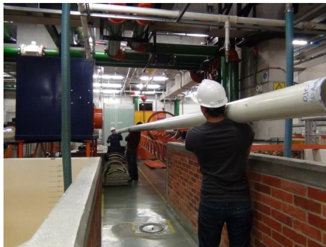
Figura 67. Ubicación de la tubería en el laboratorio (VII).
