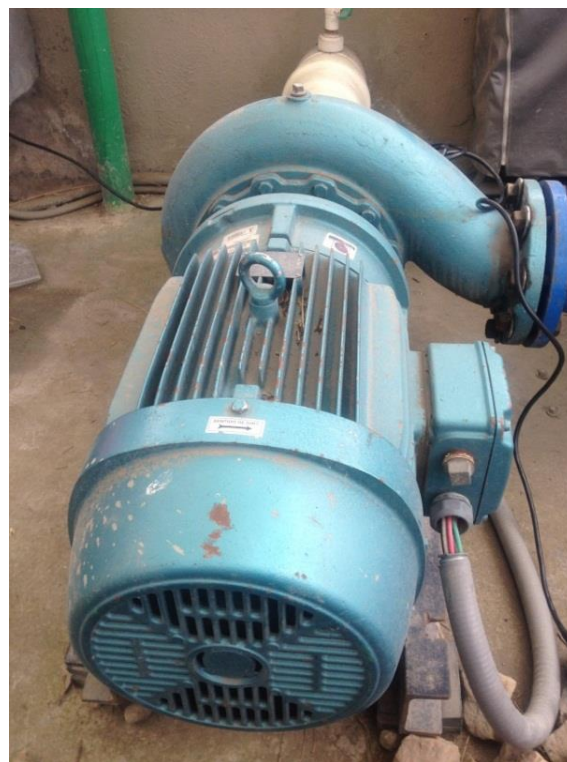
Figura 28. Sistema de bombeo en PAVCO S.A (Nieto, 2011).
