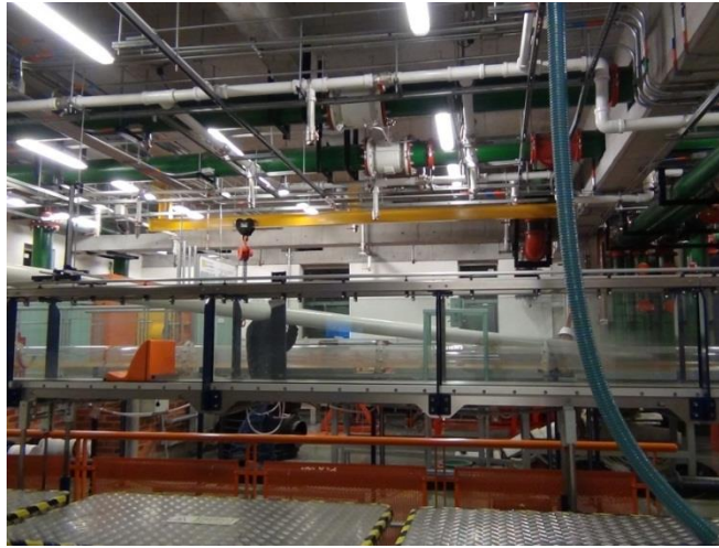
Figura 69. Ubicación de la tubería en el laboratorio (IX).
