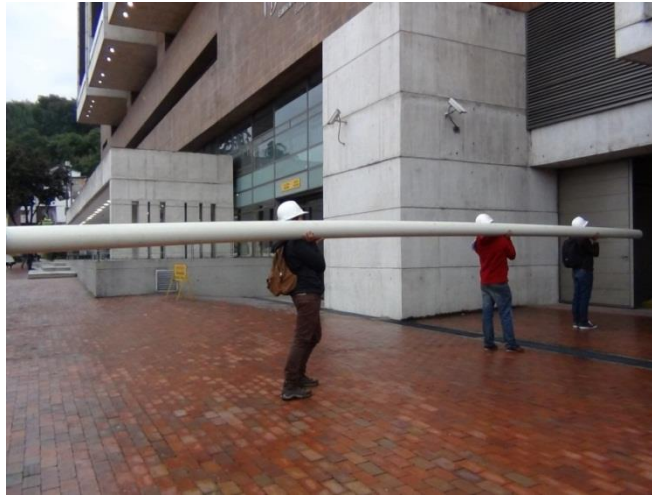
Figura 55. Desplazamiento de la tubería (IV).
