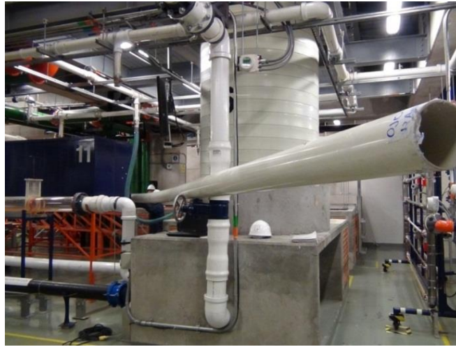
Figura 63. Ubicación de la tubería en el laboratorio (III).
