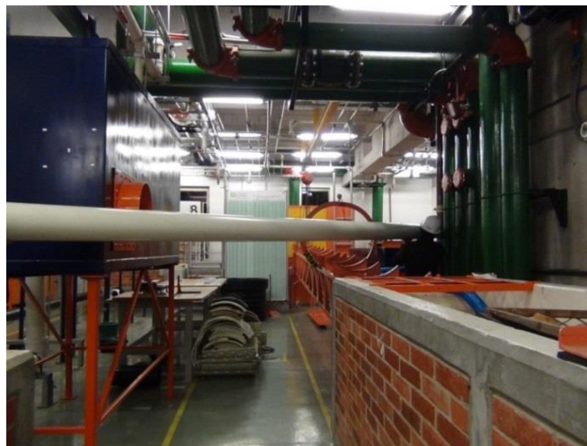
Figura 64. Ubicación de la tubería en el laboratorio (IV).
