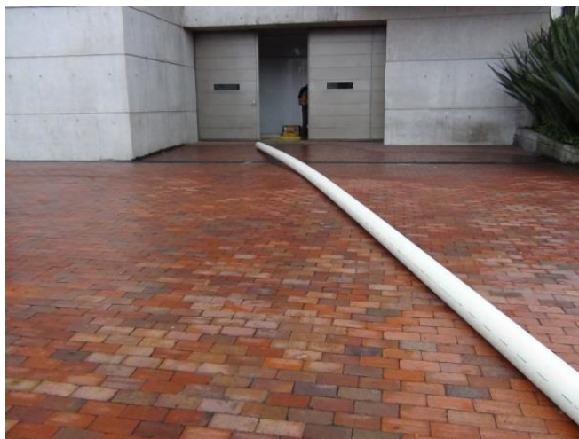
Figura 57. Desplazamiento de la tubería (VI).
