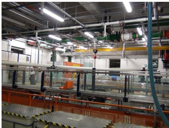
Figura 71. Ubicación de la tubería en el laboratorio (XI).
