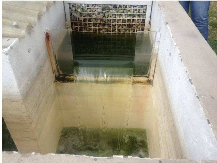
Figura 25. Vertedero de cresta delgada para la medición del caudal en PAVCO S.A (Nieto, 2011).
