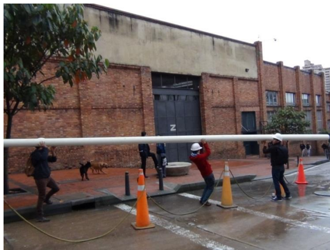
Figura 54. Desplazamiento de la tubería (III).
