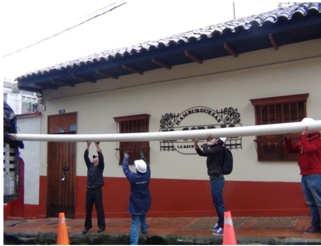
Figura 52. Desplazamiento de la tubería (I).
