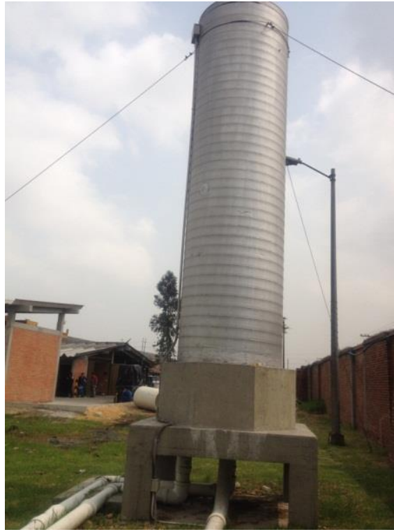
Figura 23. Tanque de alimentación en PAVCO S.A (Nieto, 2011).
