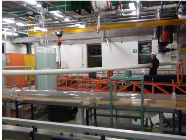
Figura 72. Ubicación de la tubería en el laboratorio (XII).
