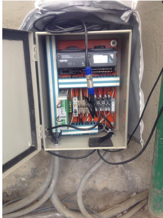
Figura 29. Sistema eléctrico del montaje en PAVCO S.A (Nieto, 2011).
