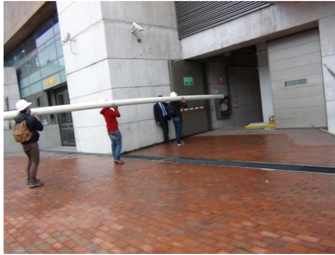
Figura 58. Desplazamiento de la tubería (VII).
