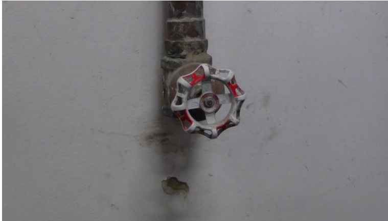
Ilustración 16. Fuente de agua potable.
