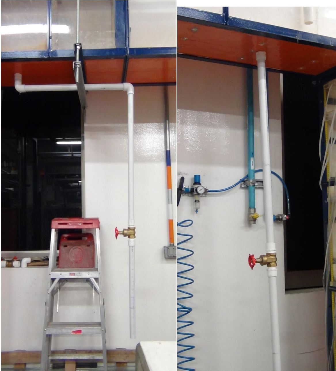
Ilustración 22. Válvulas de entrada.
