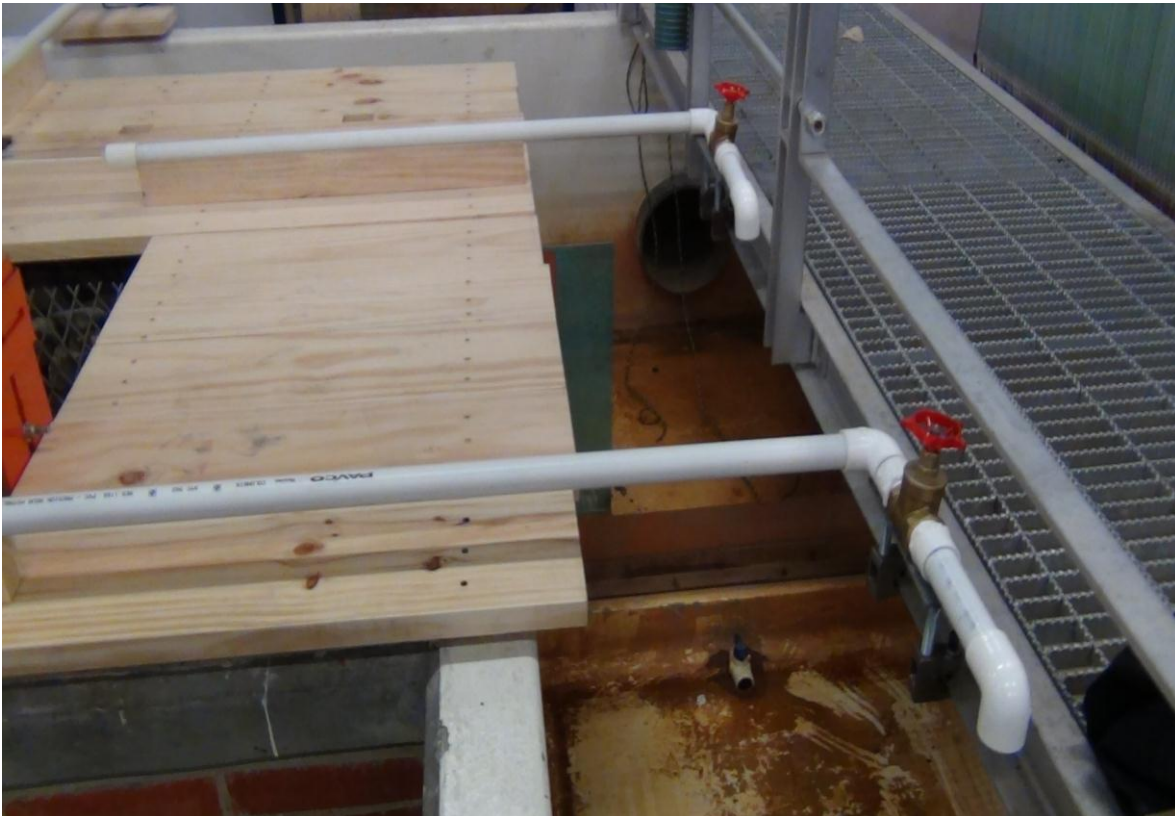
Ilustración 24. Válvulas de salida.
