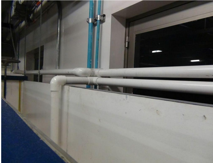
Ilustración 19. Tuberías de alimentación en tanques.
