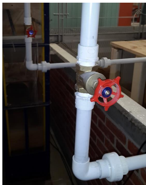
Ilustración 21. Válvulas de entrada.
