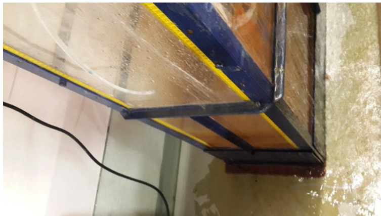
Ilustración 19. Fugas en el tanque modificado.
