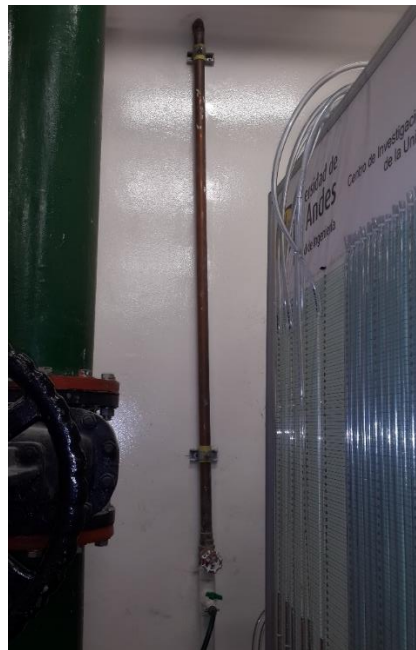
Ilustración 10. Tubería del laboratorio que alimenta el modelo.
