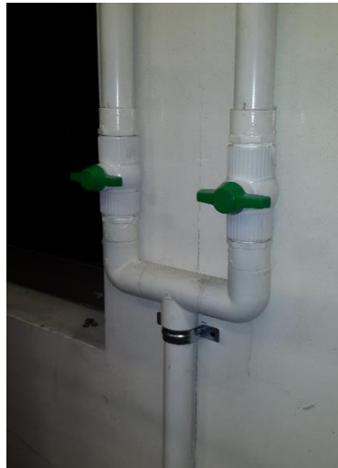
Ilustración 13. Bifurcación de la tubería de alimentación y válvulas reguladoras de caudal a los tanques.
