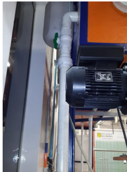
Ilustración 16. Tubería de rebose del tanque de agua limpia.
