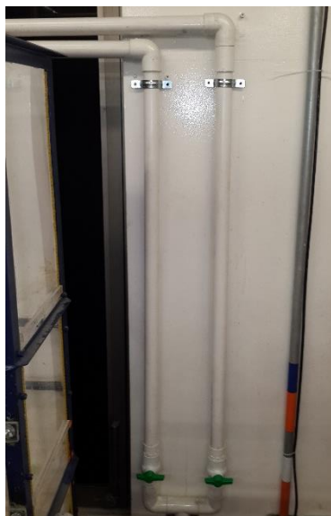
Ilustración 14. Tuberías de alimentación a los tanques.
