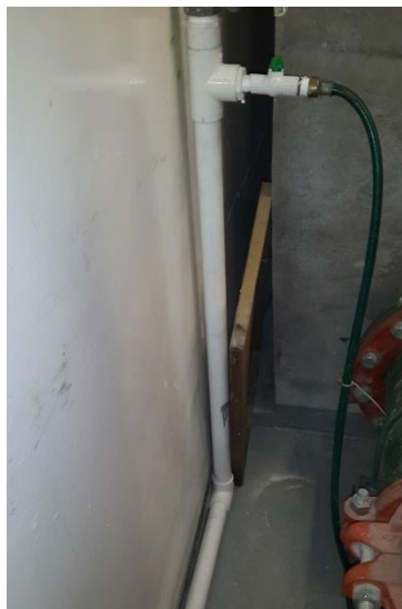
Ilustración 12. Tubería de alimentación al modelo.
