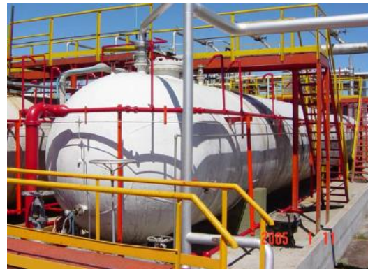
Figura 6.5- Tanque de almacenamiento tipo cigarro. (UBA).
