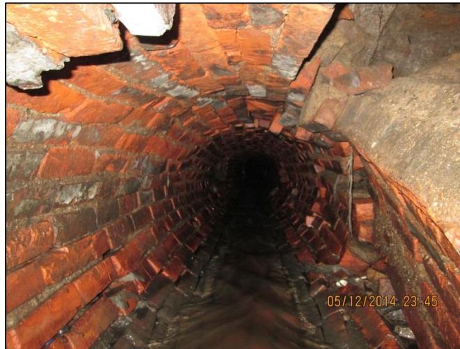
Fotografía 2.4 Falla estructural en un colector combinado.
