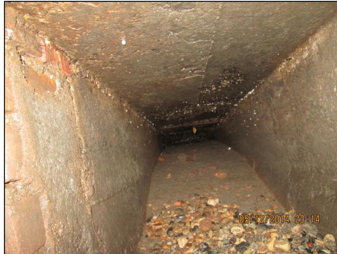
Fotografía 2.2 Colector de aguas combinadas altamente sedimentado.
