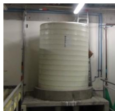
Figura 12. Tanque elevado del montaje.
