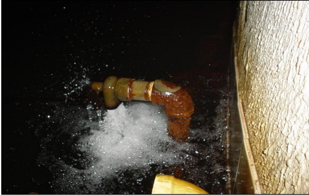
Vista 2 del Sistema de llenado del Tanque – Flotador
