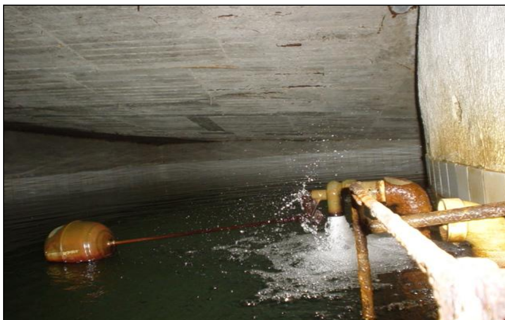
Imagen 8-4 Sistema de Autorregulación del Tanque - Flotador
