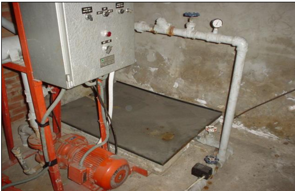
Imagen 8-5 Tanque Subterráneo en Concreto
