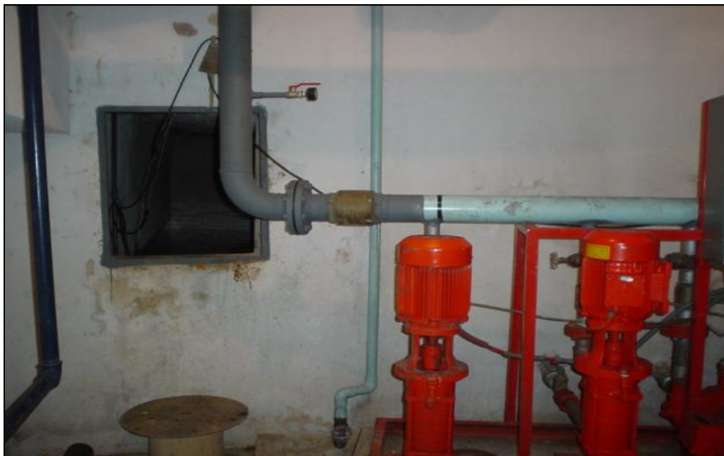
Tipo de Acceso 2 a Tanque Subterráneo
