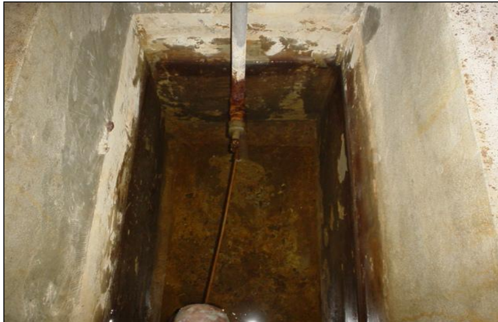
Imagen 8-1 Tanque de Almacenamiento Subterráneo en mal estado
