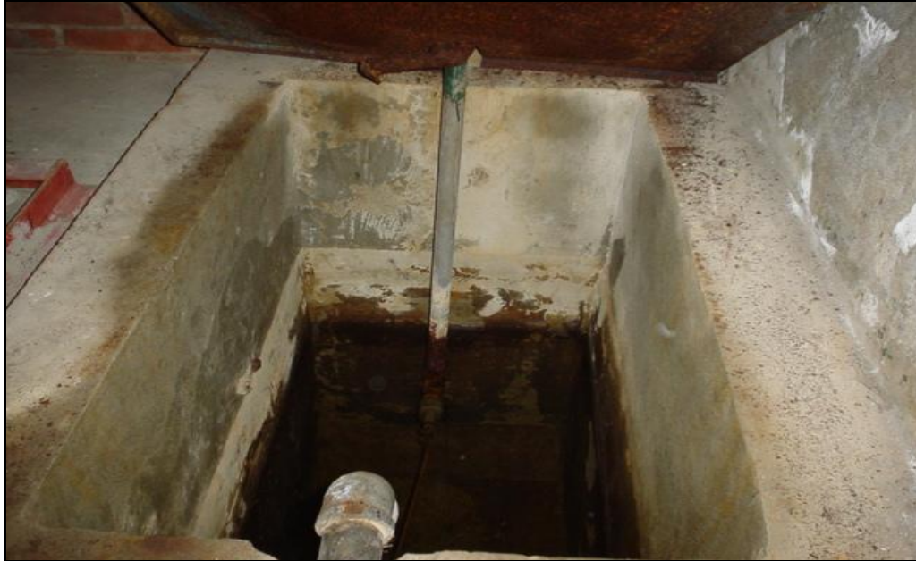
Vista Interna de Tanque Subterráneo en mal Estado
