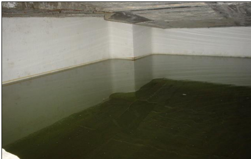
Imagen 8-2 Tanque de almacenamiento en buen estado
