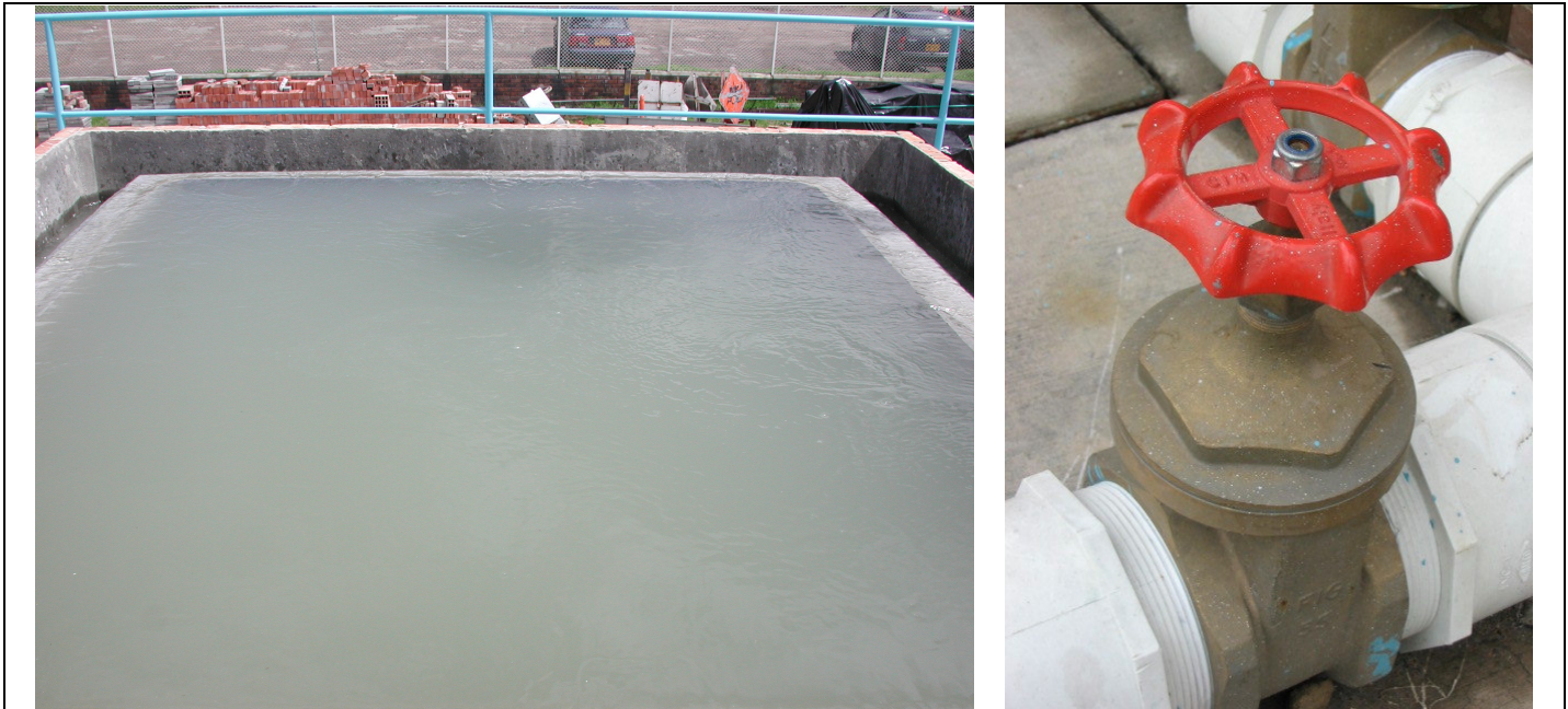
Figura 2-2 Tanque de alimentación y válvula reguladora del caudal.
