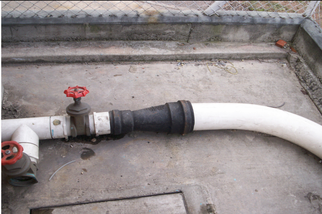
b) Válvulas de entrada a vertederos finales.
