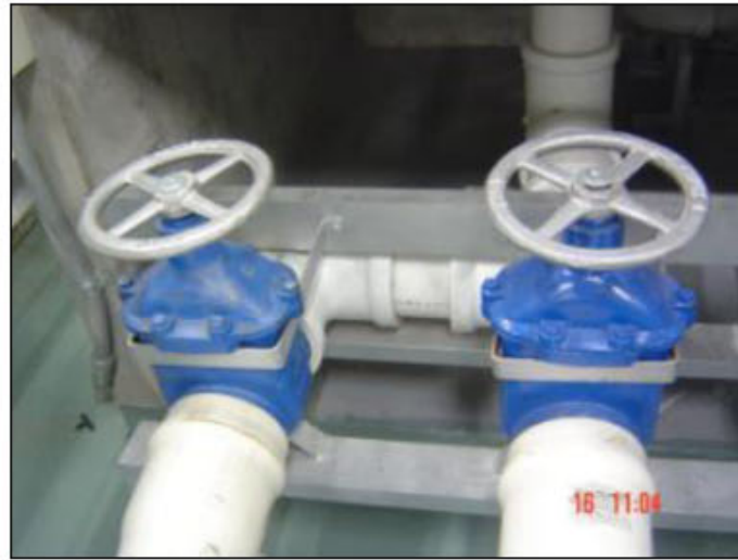
Figura 2-4. Válvulas para la regulación de caudales.
